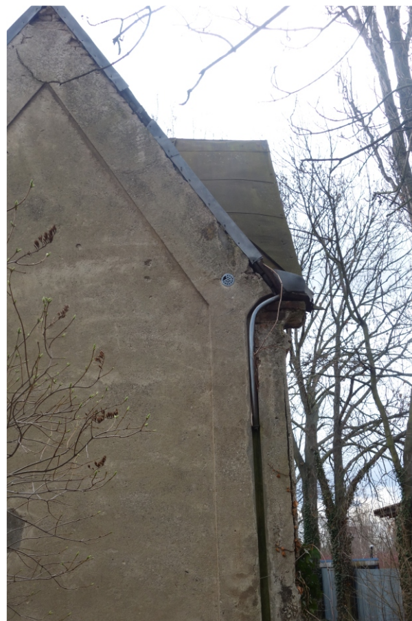
hrobka rodiny Tuzarových, poškození v místě nefunkčního svodu, krytka větracího průduchu
