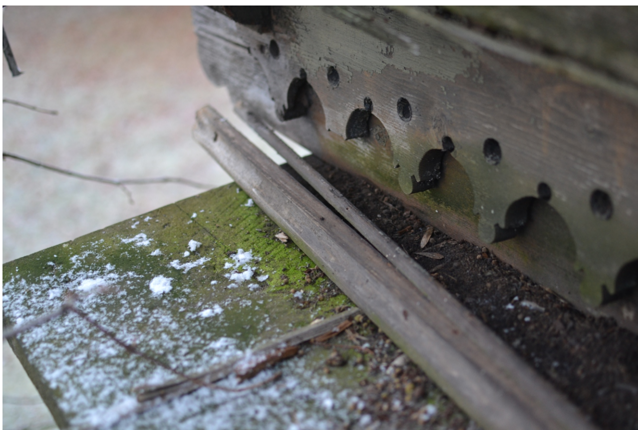
dřevěná stříška, detail poškození
