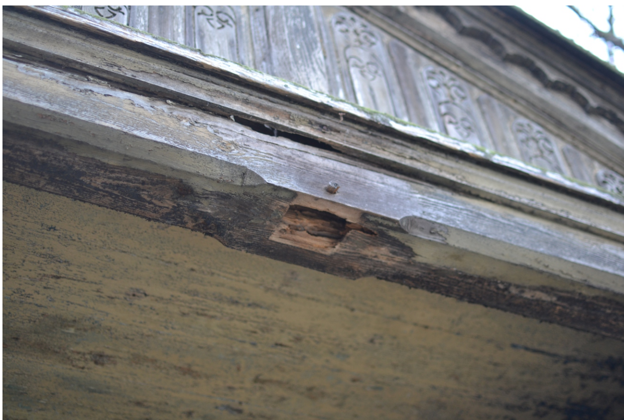
dřevěná stříška, detail poškození
