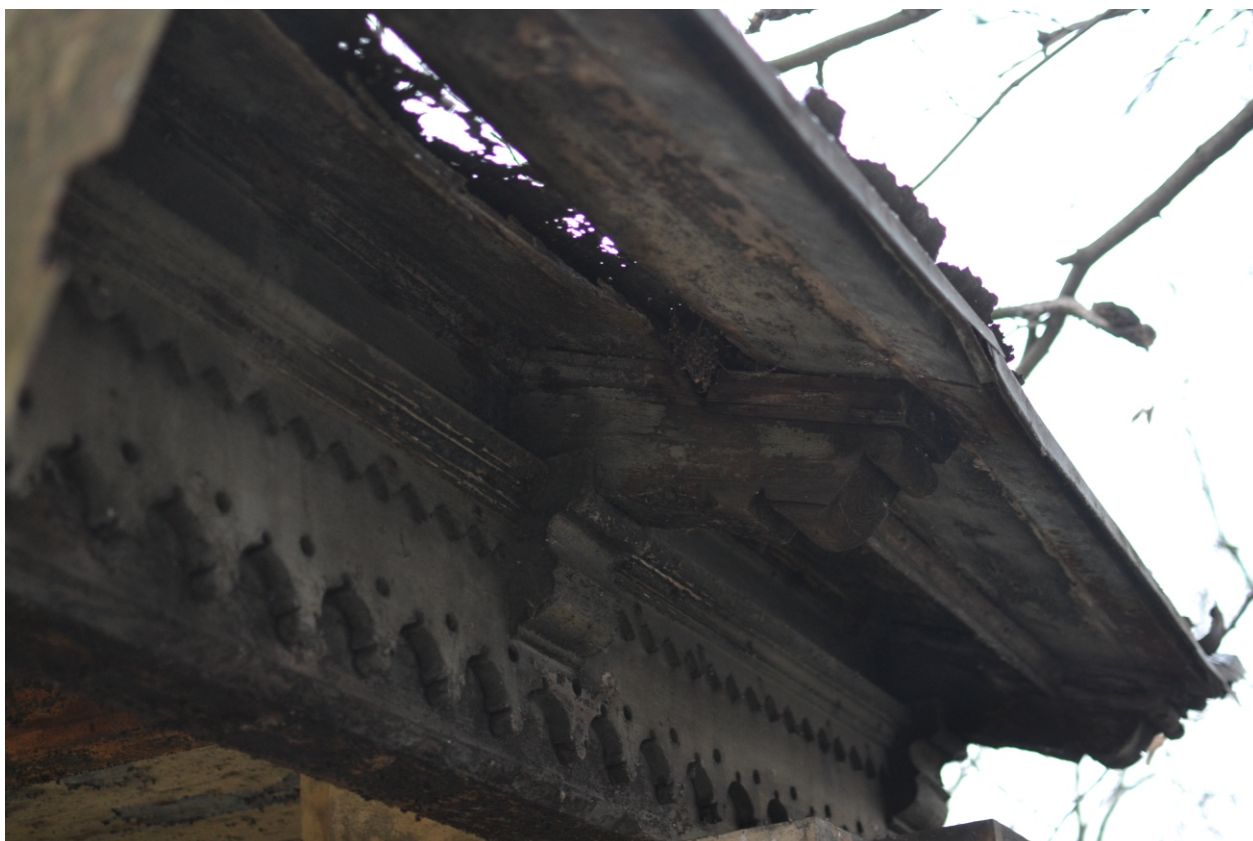
dřevěná stříška, detail poškození
