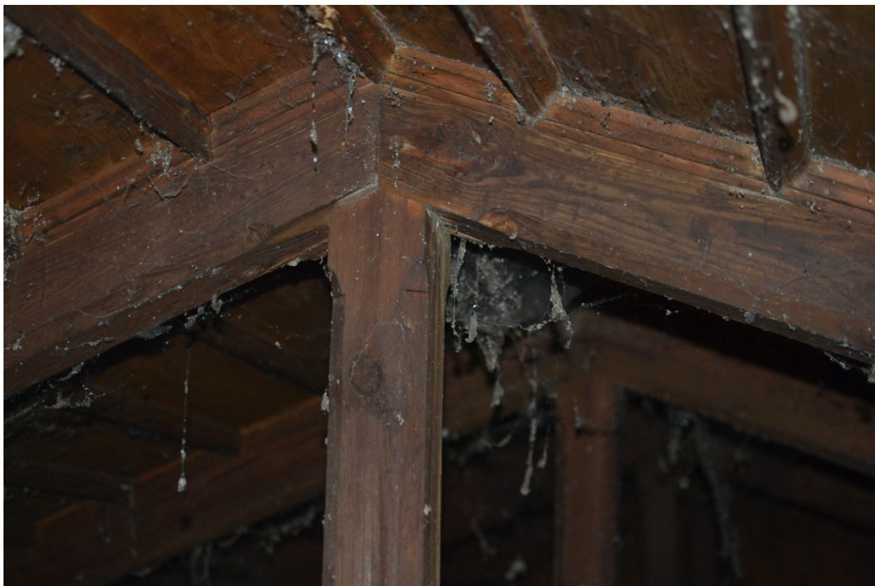
dřevěná stříška, detail poškození
