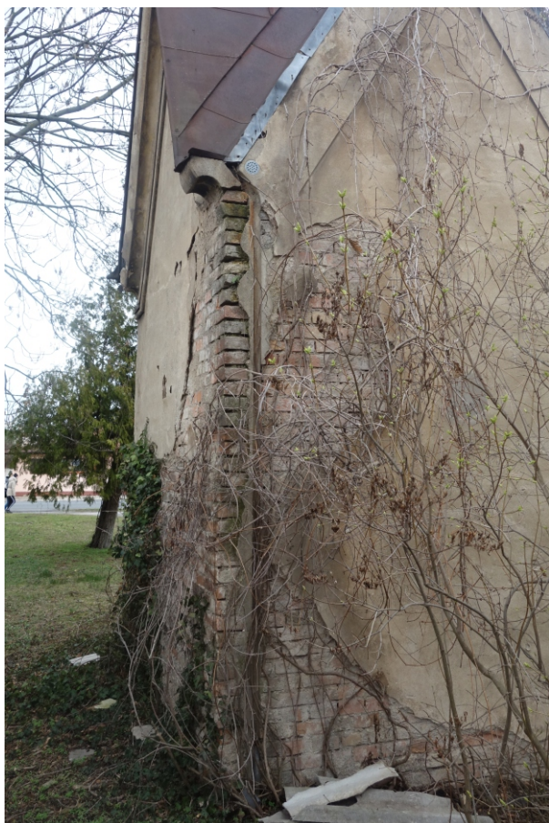
hrobka rodiny Tuzarových, poškozená omítka, chybějící svod
