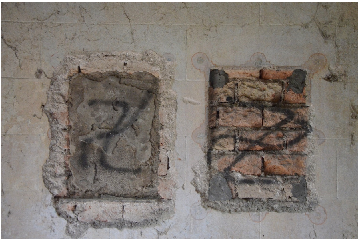
Ukázka poškození vzniklých mechanickým odstraněním náhrobních desek
