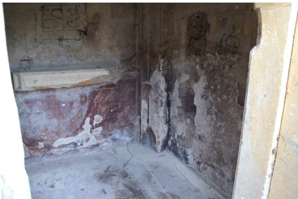
Snímek současného stavu soklových partií degradovaných vlivem dlouhodobého působení vztlínající vlhkosti
