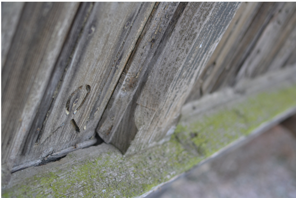
dřevěná stříška, detail poškození
