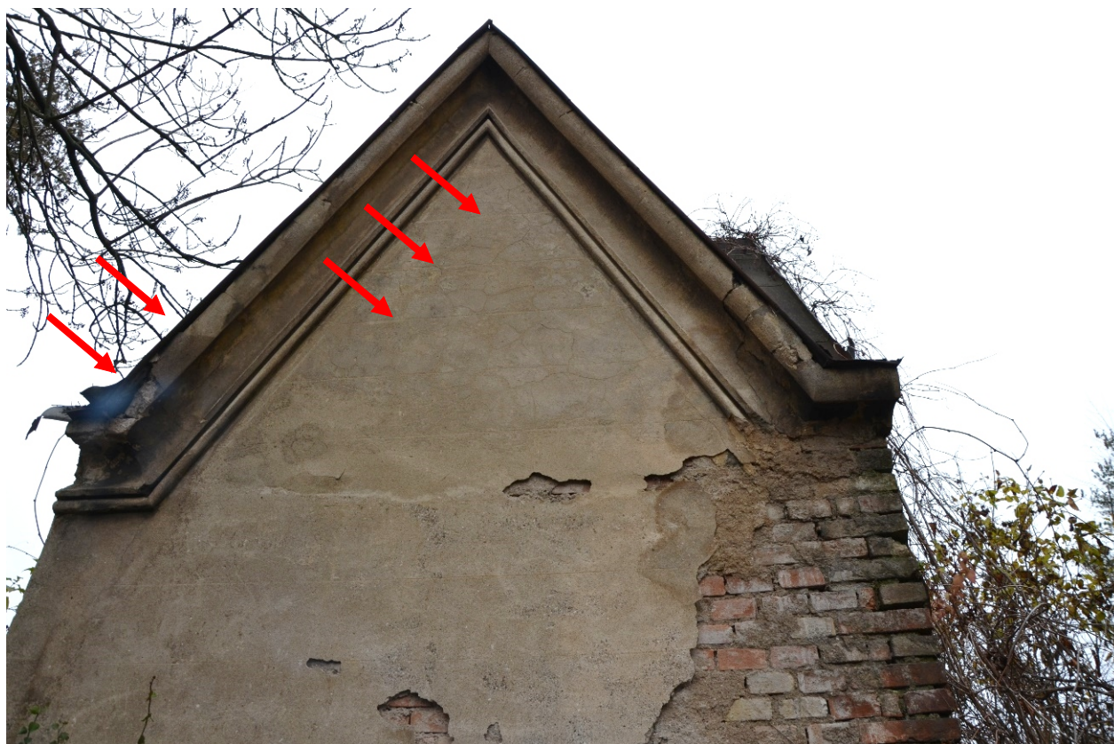
Snímek zadní strany kaple s dochovanou původní omítkovou vrstvou a jejím členění škrábanými linkami napodobující bosáž. Stav omítkové vrstvy a viditelné poškození stavby způsobené zatékáním
