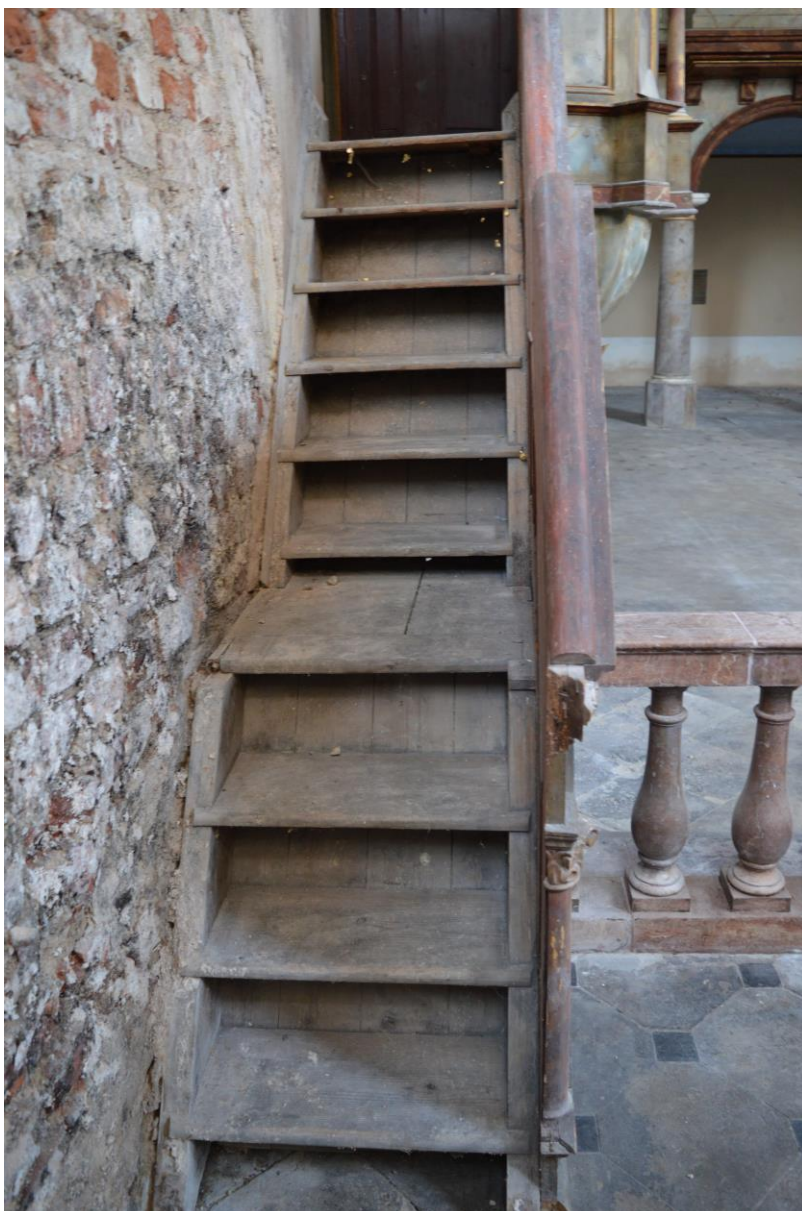
Schodiště kazatelny. Dřevo rozeschlé, znečištěné.
