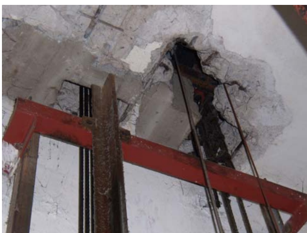
nevyhovující kotvení lan nad protiváhou
