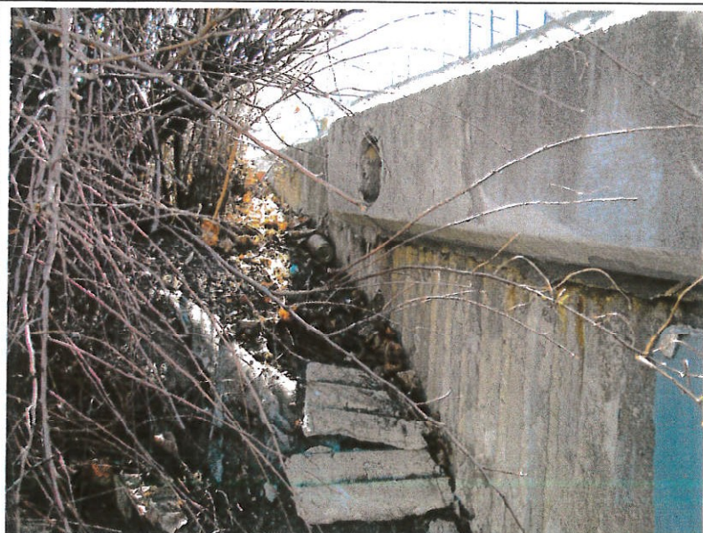
Pravobřežní opěra, nevyhovující vyústění odvodnění, odpadlá omítka provedená v rámci předešlé rekonstrukce
