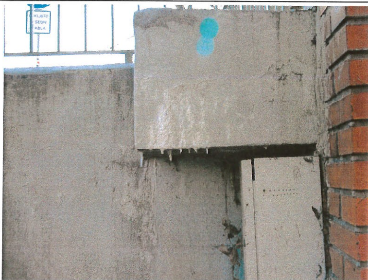
Pravobřežní opěra, průsaky v místě vyústění odvodnění
