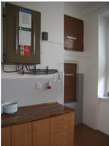
vrchní stanice výtahu v přípravné kuchyňce
