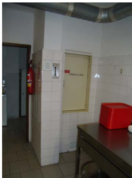
spodní stanice výtahu v kuchyni
