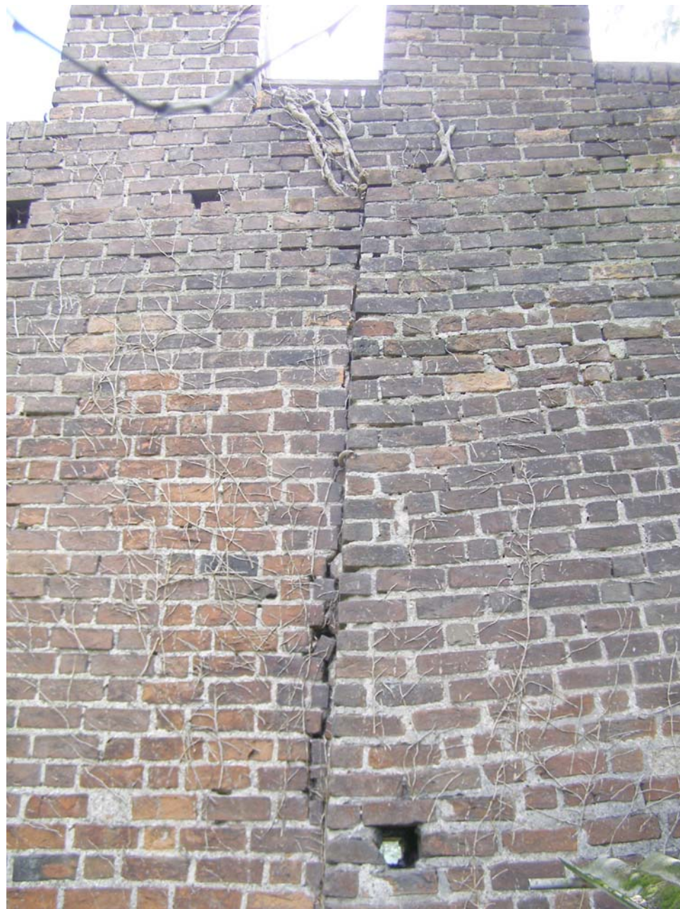
10. Vnitřní strana hradeb - spára v místě lomu hradby
